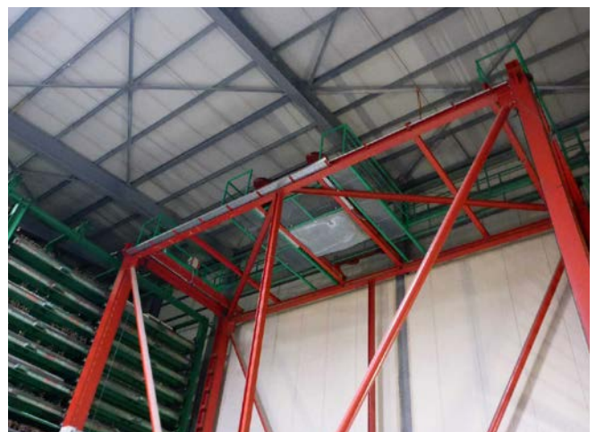
Abb.11 Arbeitsbühne für Wartungsarbeiten am Hubwerk des Regalbediengerätes
